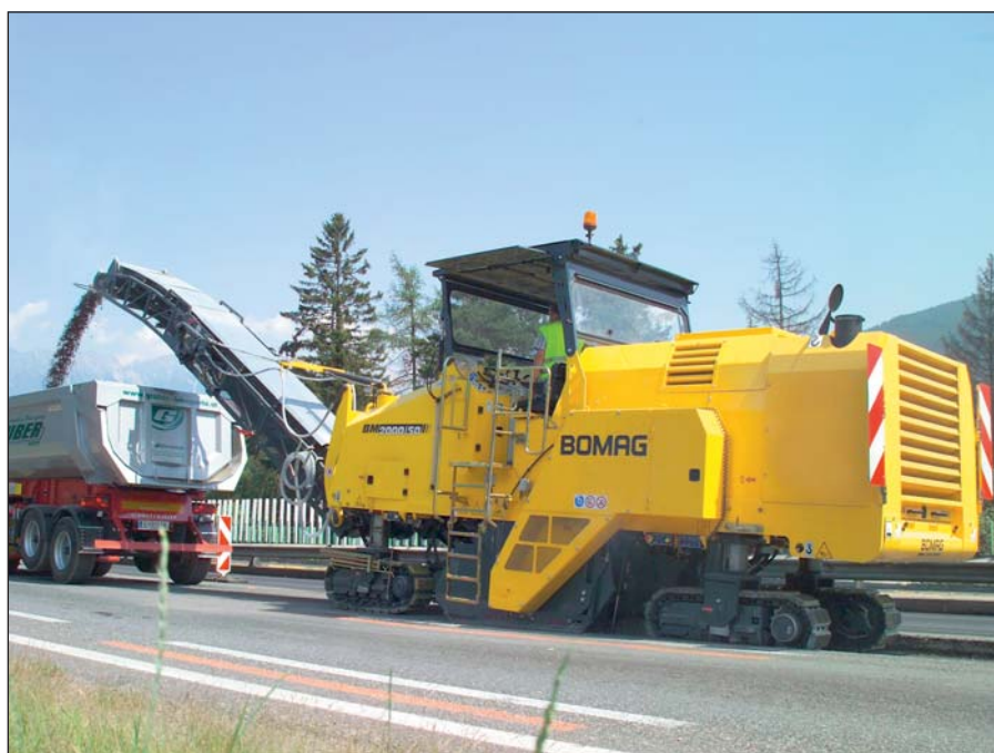
Precisione e produttività nei lavori di fresatura selettiva sulle autostrade grazie ai sistemi di livellazione in dotazione facili da usare.
